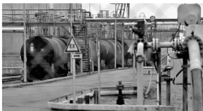
Waggonen hinter dem Zaun: In Barenburg werden die Schwefelzüge befüllt. Sie nutzen dann einen Teil des Sulinger Kreuzes.
