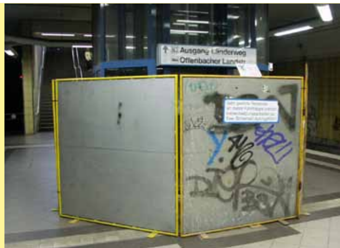
Wochenlang stand der Aufzug der S-Bahnstation Mühlberg. Ein Reparaturtermin wurde nicht angegeben.
